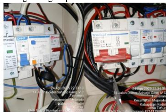
Gambar 7. Uji Short Circuit Pada Mcb Dc dan Rcbo
