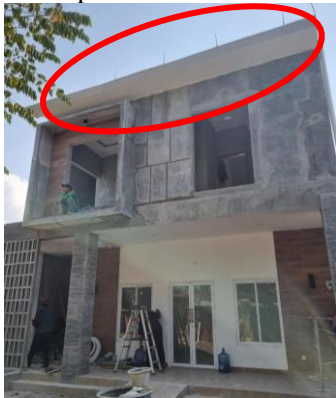
Gambar 5. Tampilan Bangunan Klinik Supit Wates dengan Instalasi Proteksi Petir
