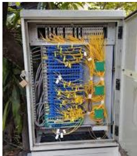
Gambar 2.3 Optical Distribution Cabinet (ODC)
