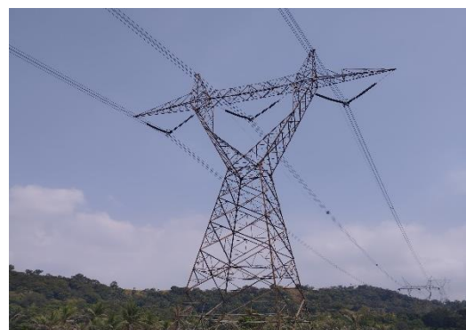
transmisi jaringan listrik.
