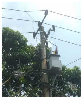
Gambar 3. Trafo Distribusi Pada Gardu LUS di Desa Luwuk Kampung Panjon
