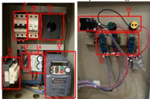
Gambar 17. Tampak dalam Panel
