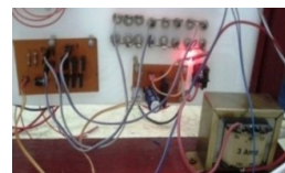
Gambar 12. Realisasi power supply 12 Volt, 5 Volt dan 3,3 Volt.
