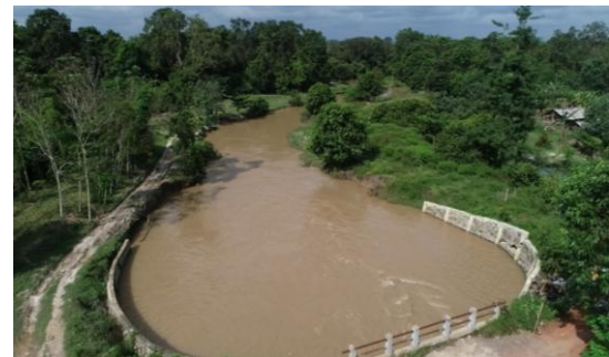
Gambar 16. Kerusakan Tanggul Sungai
